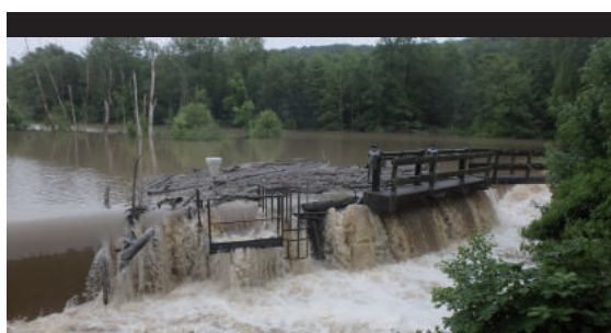
Bassin de Saint Forget
